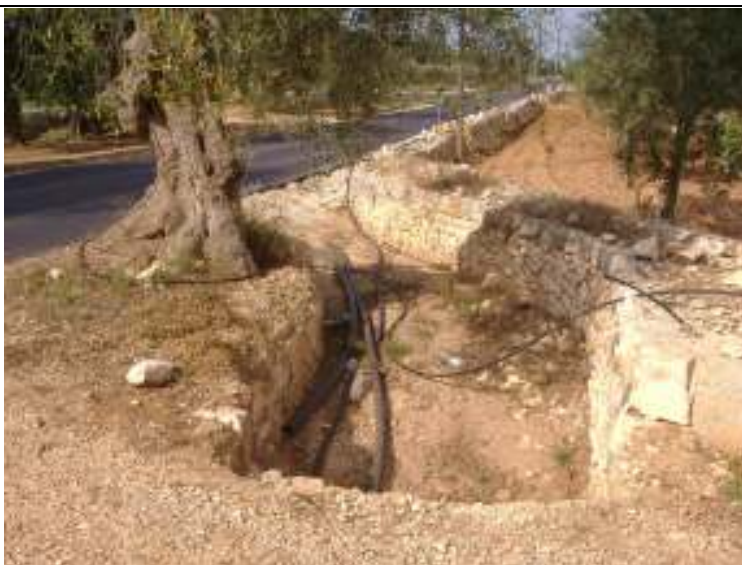
Foto n. 16 – Le acque piovane intercettate dalle caditoie affluiscono nel canale laterale lungo pochi metri e poi scorrono sulla S.C. Rizzitello
