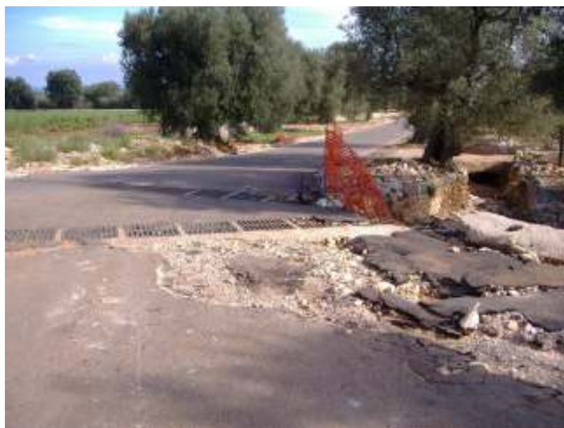
Foto n. 18 – S. C. Rizzitello: il nuovo asfalto scalzato dalle acque piovane dilavanti
