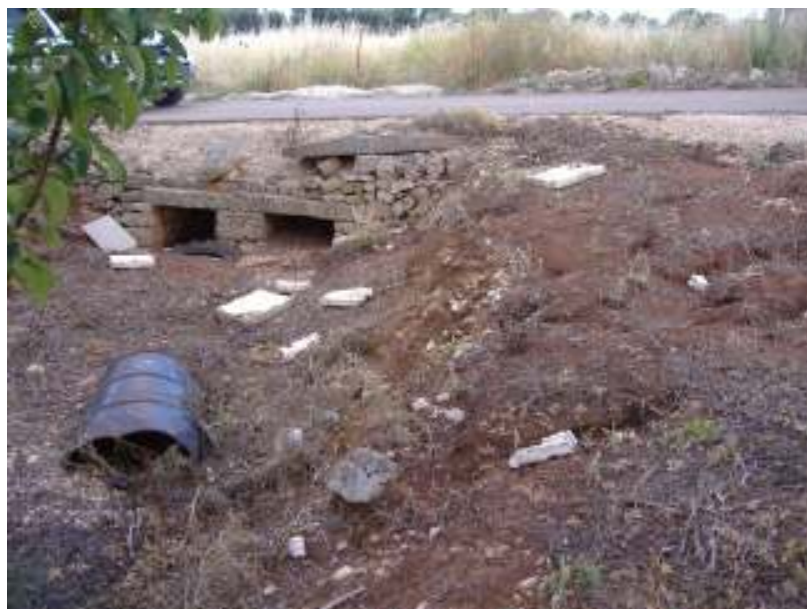
Foto n. 7 – Tombino su Lama S. Vincenzo ostruito da detriti e rifiuti
