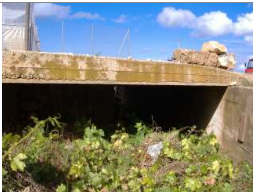
Foto n. 6 – Tombino stradale sotto la S.C. San Vincenzo occluso da detriti
