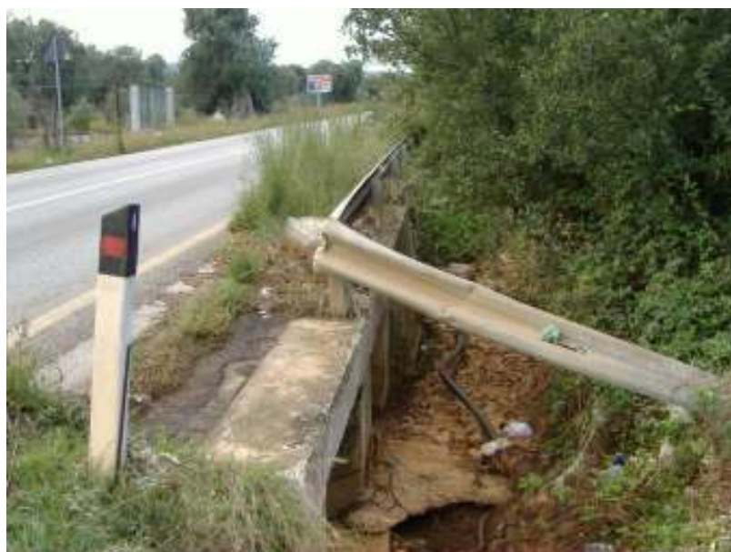
Foto 2 – canale lungo la S.P. Monopoli – Castellana vicino la cava Cemensud
