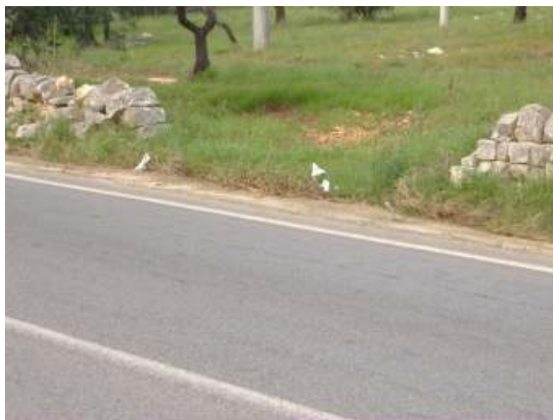
Foto 1 –Sbocco del torrente sulla sede stradale della S.P. Monopoli – Castellana
