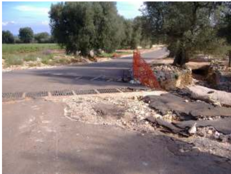
Foto n. 18 – S. C. Rizzitello: il nuovo asfalto scalzato dalle acque piovane dilavanti
