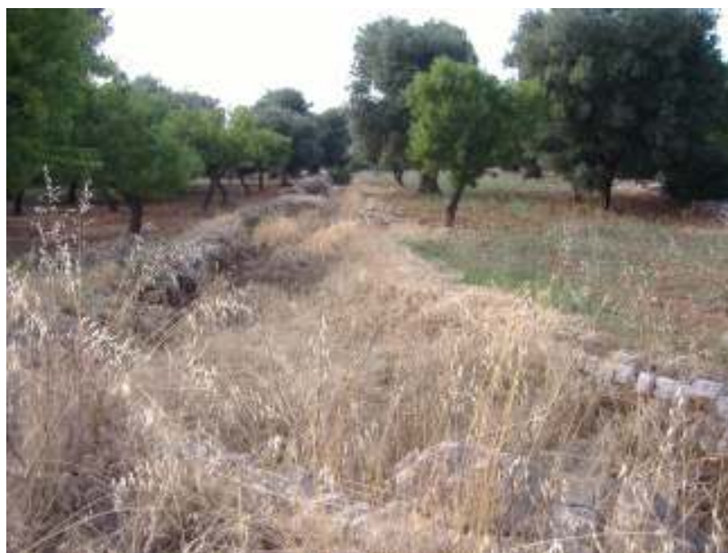
Foto n. 8 – Canale pieno di detriti vicino l'incrocio S.C. Cristo delle Zolle e S. C. Guidano.
