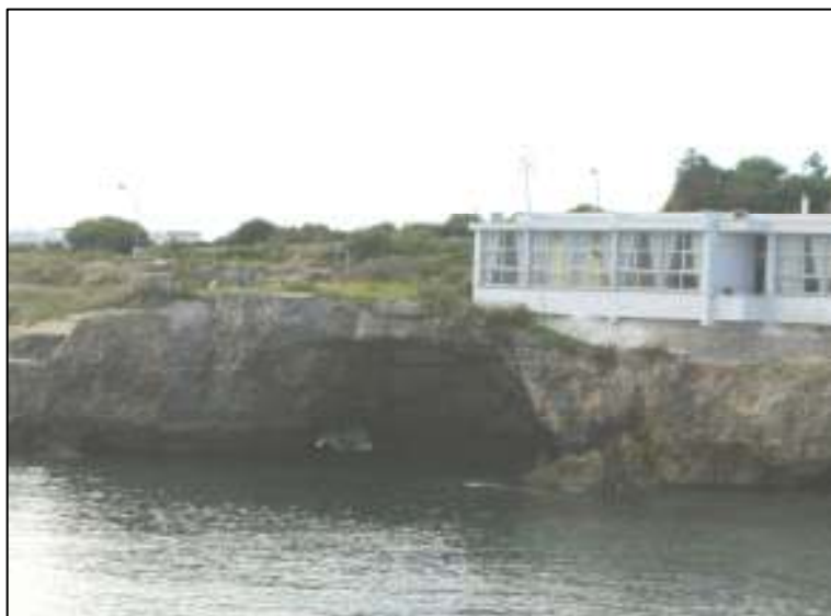
Foto n. 19 - Dissesti per distacco di rocce non particolarmente fratturate.
