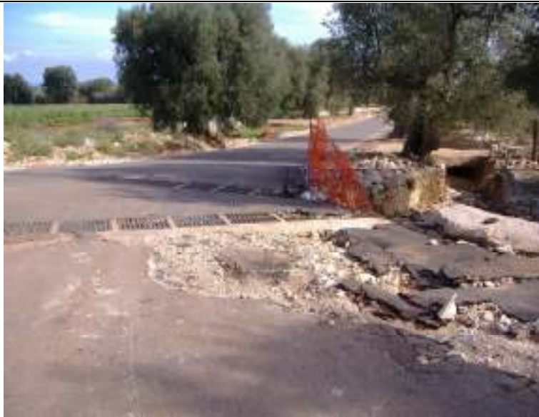
Foto n. 18 – S. C. Rizzitello: l'asfalto nuovo scalzato dalle acque dilavanti
