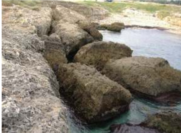
Foto n. 18 - Esempio di dissesto per "toppling" in un punto della costa rocciosa.
