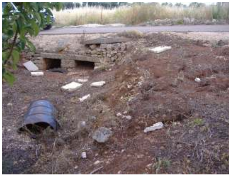
Foto n. 7 – Tombino su Lama S. Vincenzo ostruito da detriti e rifiuti
